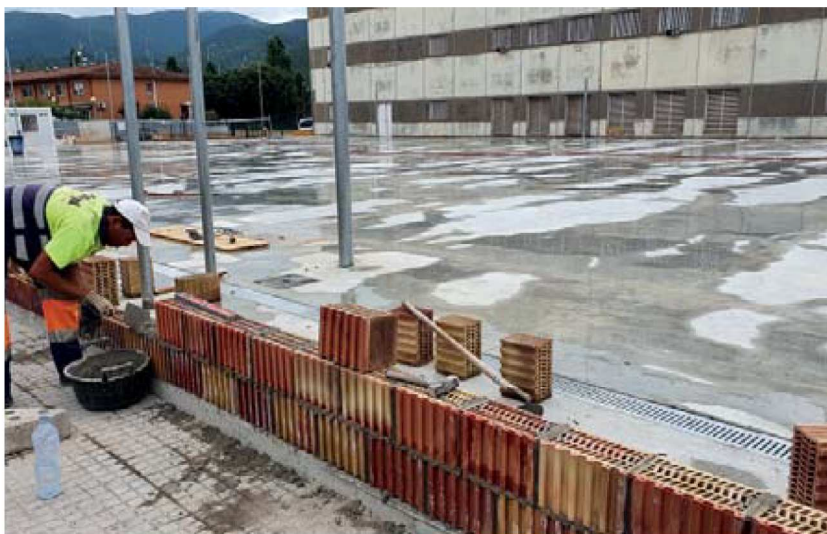
La nova pista esportiva exterior annexa al pavelló Miquel Poblet ja està pavimentada i ara està en construcció el mur perimetral
